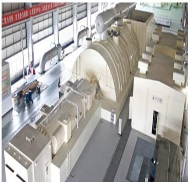
江苏泰州 1000MW 汽轮发电机 1000MW turbo-generator for Jiangsu Taizhou
